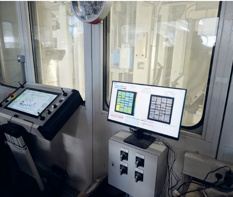
Visualisierung der Qualitätskontrolle am Leitstand der Betonsteinfertigungsanlage Multimat RH 1500-4
