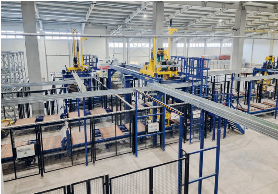
Komplexe Anlage mit Masa-Technik: Trockenseite mit zwei Rücktransporten, Paketierung, Transportpalettengreifer und Zuführsysteme für die leeren Produktionsunterlagen. Als Komplettanbieter liefert Masa auch die Kabelkanäle.
