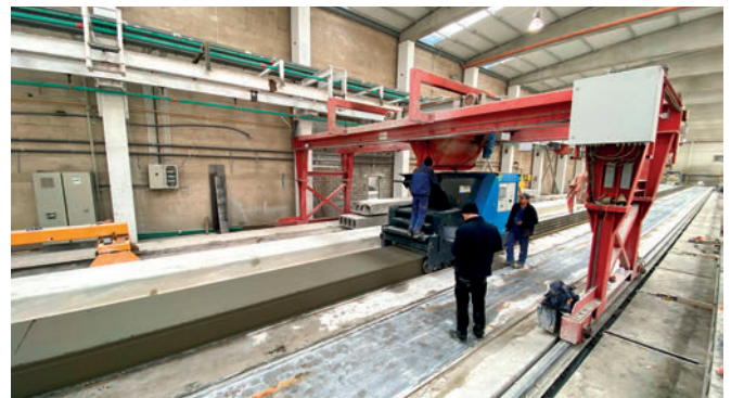
Dank der professionellen Arbeit war der Extruder innerhalb eines Tages betriebsbereit.
