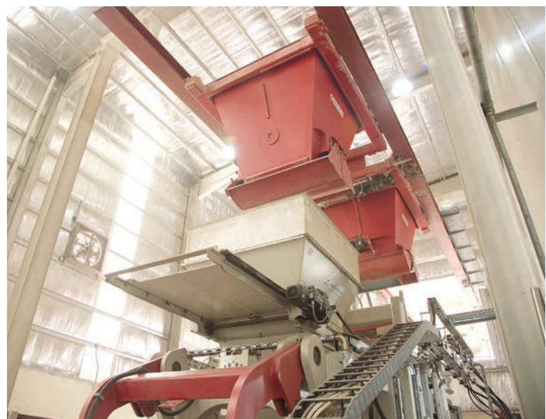
Le double convoyeur à benne transfère le béton de corps et de parement dans les silos de stockage correspondants de la machine de production de blocs.
