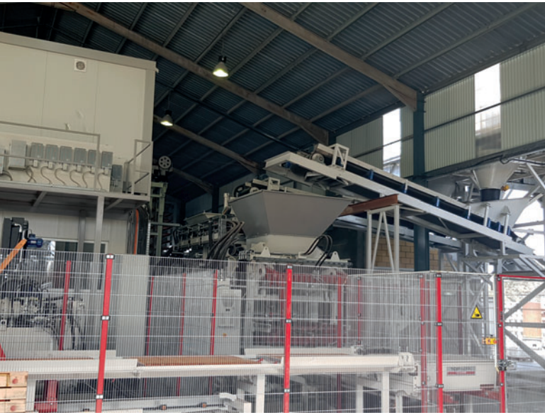
Alimentazione dei pannelli di appoggio alla macchina Hess Multimater RH1500-3MVA
