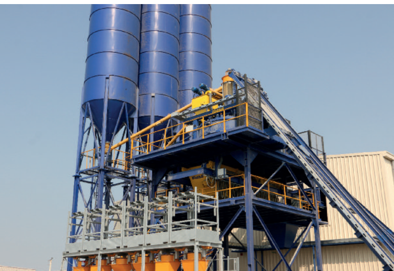
Węzeł betoniarski Masa: pod mieszarką zamontowano system zasobników poruszających się po estakadzie.
