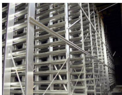
Komora dojrzewania zamontowana przez firmę HS Anlagentechnik ma 22 poziomy o odstępach 330 mm.
