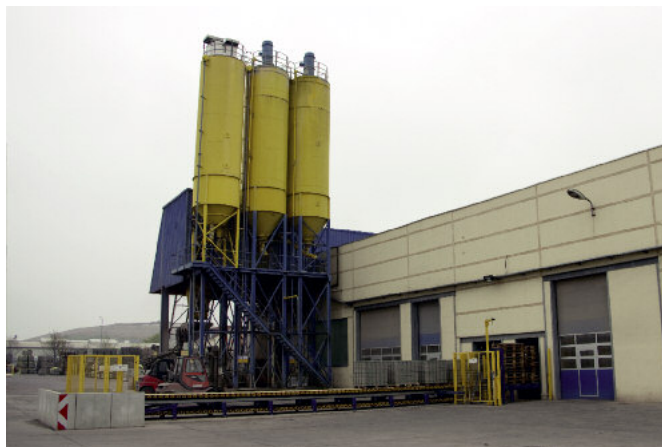
Zmodernizowana linia technologiczna do produkcji wyrobów betonowych w zakładzie firmy Kann w Lipsku.
