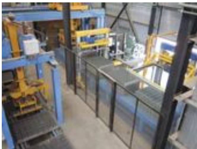
Obieg powrotny z centrownikiem i przenośnikiem paczek wyrobów.
