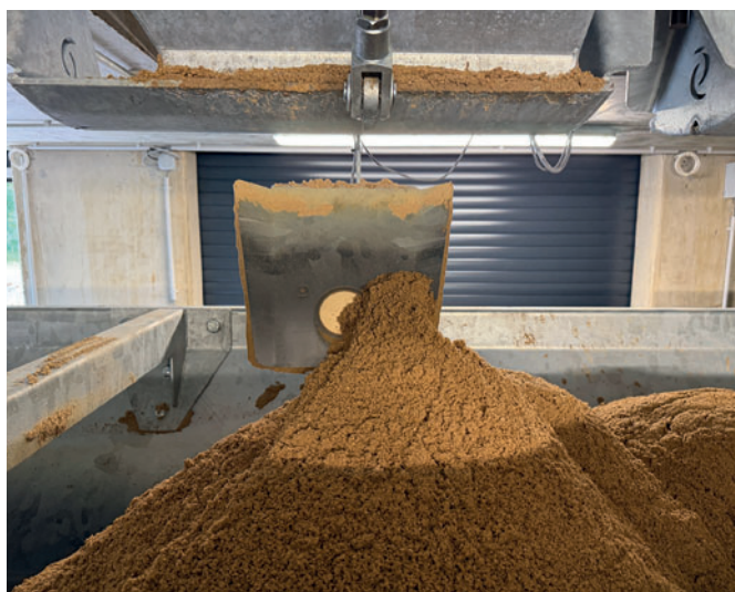
На затворах песчаных камер силоса установлены датчики влажности
