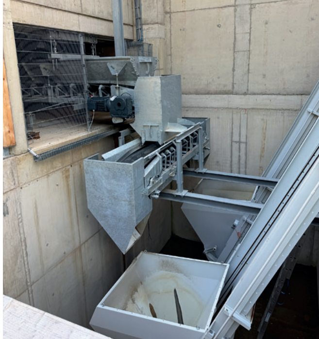
Распределительный ленточный транспортер заполняет один из двух загрузочных подъемников в зависимости от направления движения
