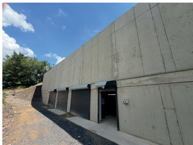
Хранение заполнителей осуществляется в расположенном под землей 7-камерном рядном силосе с общим объемом около 400 м 3
