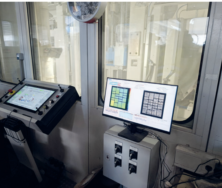
Визуализация контроля качества на пульте управления линией по производству бетонных блоков Multimat RH 1500-4
