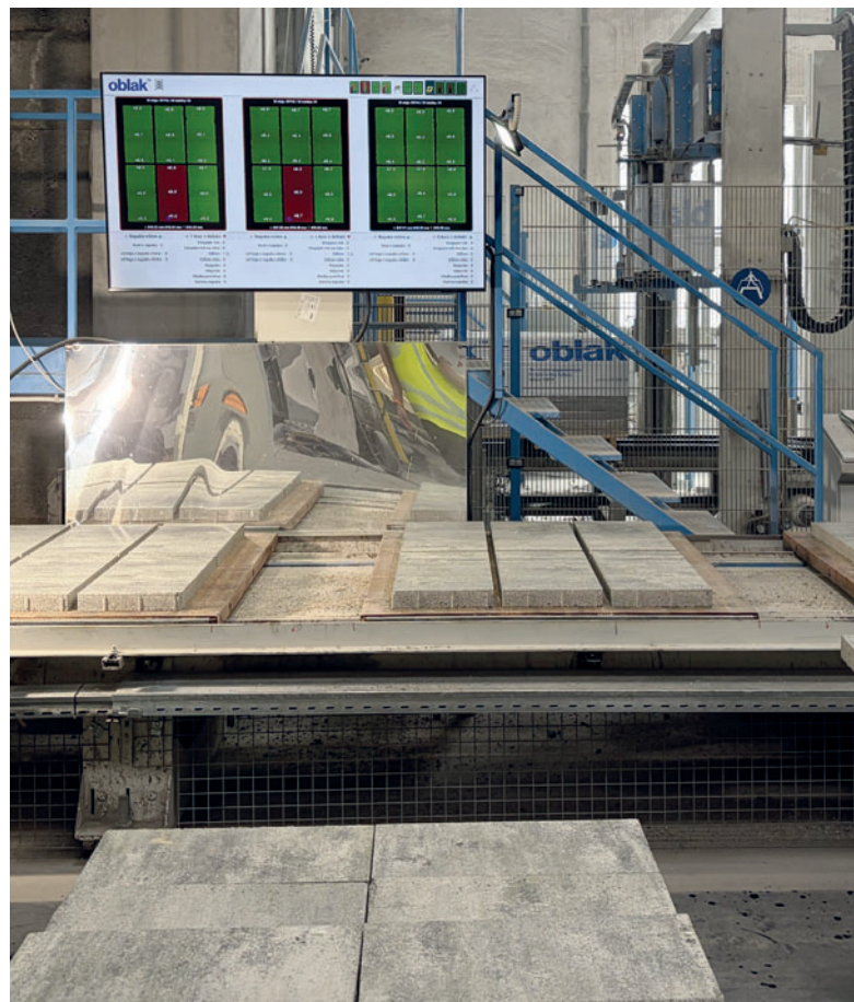
Встроенная система контроля качества на сухой стороне
