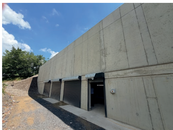
Kruszywo jest magazynowane w siedmiokomorowym zasobniku szeregowym o łącznej pojemności około 400 m 3 , zlokalizowanym poniżej poziomu posadzki.
