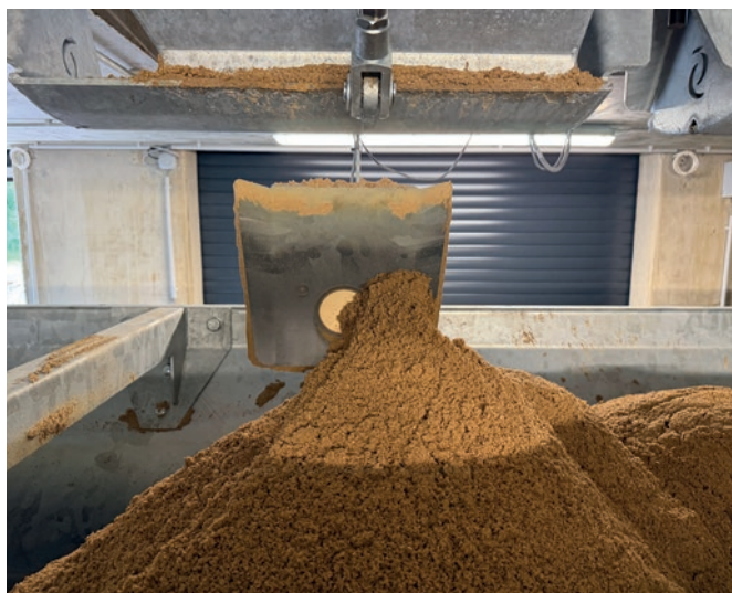
Na zasuwach komór z piaskiem zamontowano sondy do pomiaru wilgotności.
