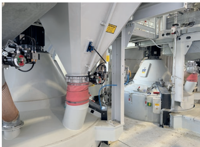
Gli elementi centrali del nuovo impianto di miscelazione doppio installato sono i due miscelatori planetari Wiggert di tipo HPGM 1875.
