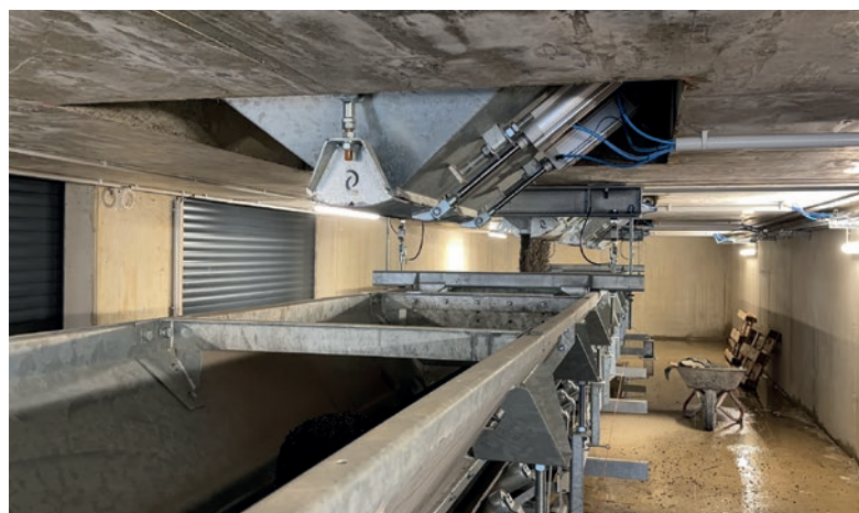
Il dosaggio degli aggregati avviene tramite doppie saracinesche di dosaggio integrate nel fondo delle camere del silo.
