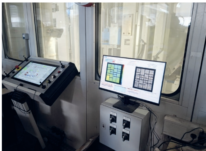
Visualizzazione del controllo qualità alla stazione di controllo dell'impianto per la produzione di masselli in calcestruzzo Multimat RH 1500-4
