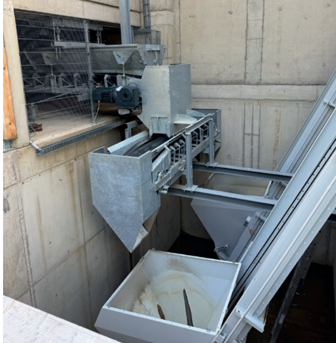
La bande de distribution remplit, selon le sens de marche, l'un des deux élévateurs de chargement.
