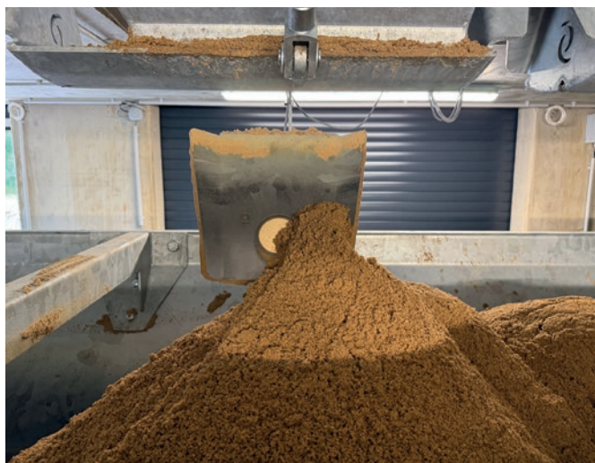
Des sondes de mesure de l'humidité sont installées sur les vannes des chambres de sable du silo.
