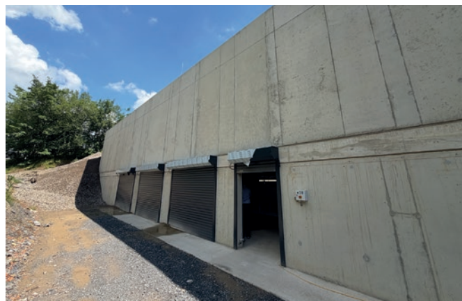
Le stockage des granulats s'effectue dans un silo en ligne à 7 chambres, situé en souterrain, d'un volume total d'environ 400 m 3 .
