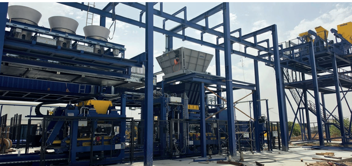
Todavía en fase de montaje, pero ya claramente reconocible: la Masa XL-R 9.1 con el sistema Multi-Color instalado constituye el corazón de la nueva línea de producción.
