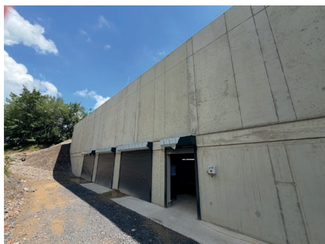
El almacenamiento de los áridos tiene lugar en un silo en serie de 7 cámaras, situado bajo rasante, con una capacidad de almacenamiento total de aprox. 400 m³.
