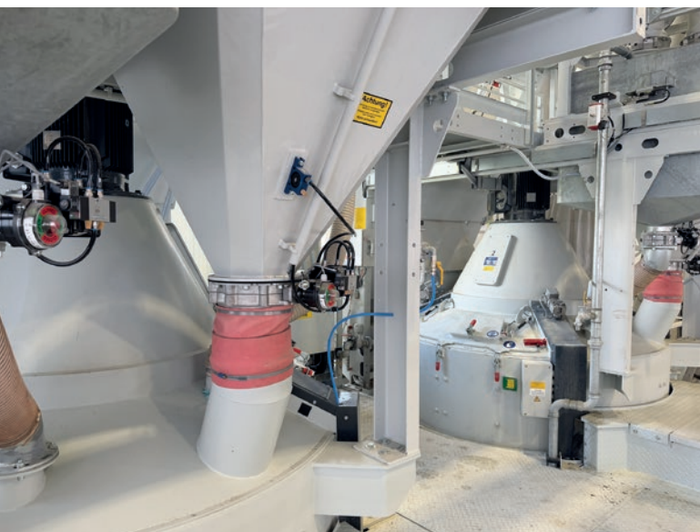
Kernelemente der neu installierten Doppelmischanlage sind die zwei Wiggert-Planetenmischer vom Typ HPGM 1875.
