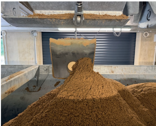
An den Verschlüssen der Sandkammern des Silos sind Feuchtemesssonden angebracht.
