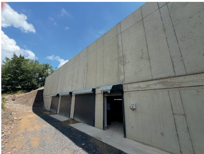
Die Lagerung der Gesteinskörnungen erfolgt in einem unterflur angeordneten 7-Kammer-Reihensilo mit einem Gesamtvolumen von ca. 400 m 3 .
