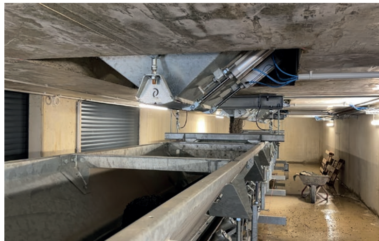
Die Dosierung der Gesteinskörnungen geschieht über in den Boden der Silokammern eingelassene Doppeldosierverschlüsse.
