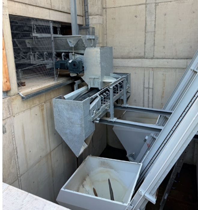
Das Verteilerband befüllt je nach Laufrichtung einen der beiden Beschickungsaufzüge.
