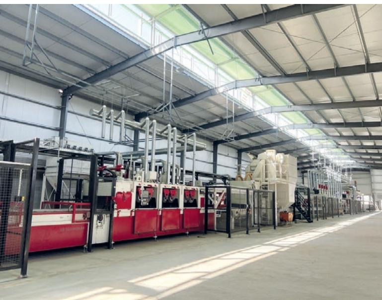
Ligne de finition complète
