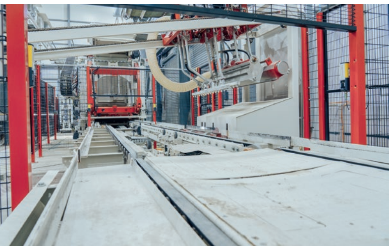
Impianto di lavaggio dal lato umido
