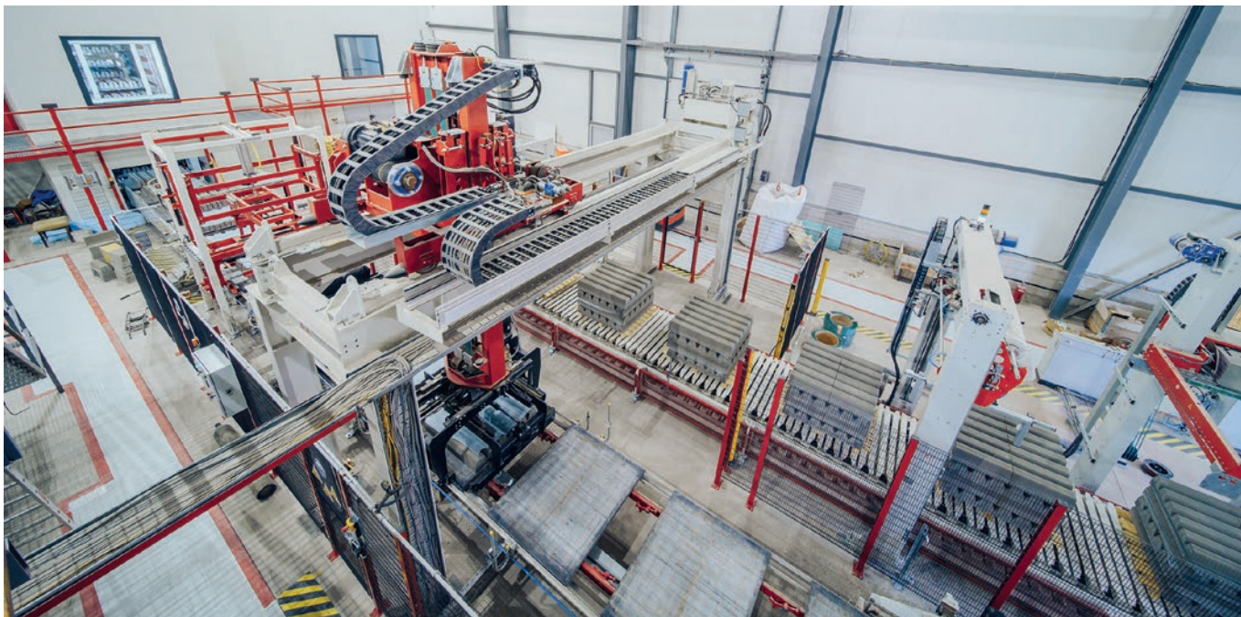
L'empaqueteur récupère les couches de blocs, les aligne et les dépose sur la ligne d'évacuation
