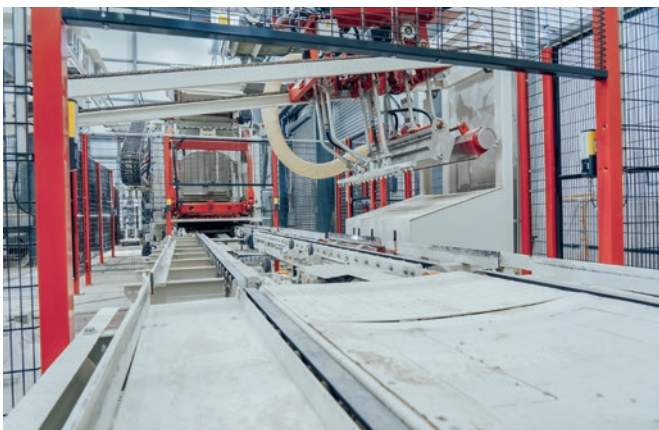
Installation de lavage côté humide
