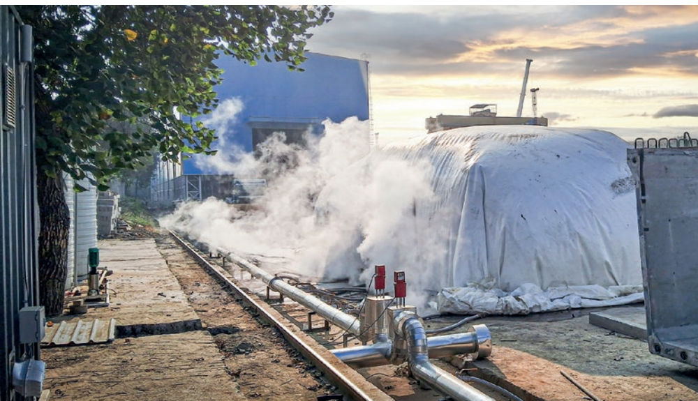
System parowej pielęgnacji betonu Kraft z izolowanymi przewodami pary oraz automatycznymi zaworami pary, zamontowany w zakładzie firmy Longspan Structures Pvt. Ltd.
