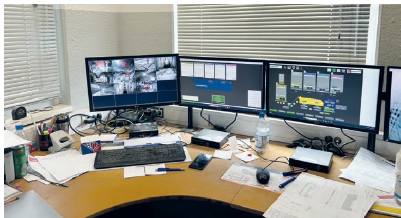
Pomieszczenie sterownicze węzła betoniarskiego.
