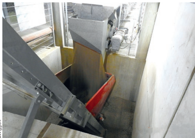
Napełnianie kosza zasypowego.
