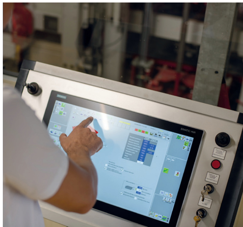
操作人员通过西门子 SCADA 系统监控并微调生产流程，确保持续稳定的产品质量
