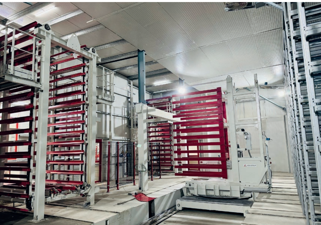
Komora dojrzewania z windą piętrującą, windą rozpiętrującą i wózkiem wielowidłowym.
