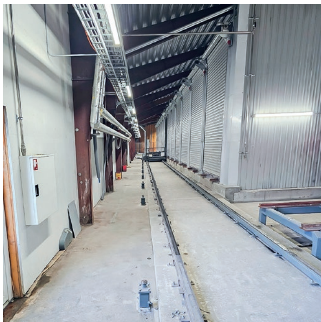
13 nowych komór dojrzewania FIFO z izolowanymi, aluminiowymi drzwiami rolowanymi z własnym napędem.
