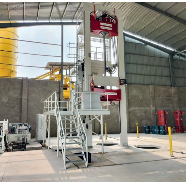
Zamontowana prasa radialna RP 1225-4.
