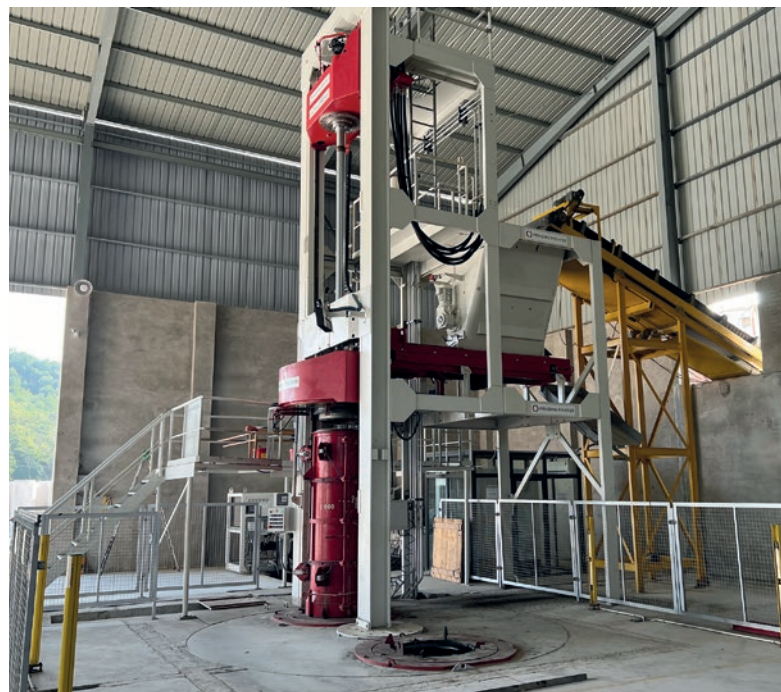
Messa in funzione della pressa radiale
