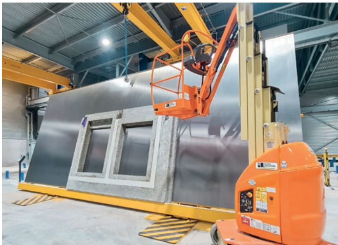
Die Kippeinrichtung in der neuen Halle bringt die fertigen Wandelemente in eine vertikale Lage und ermöglicht somit eine sichere und bedienerfreundliche Entnahme.
