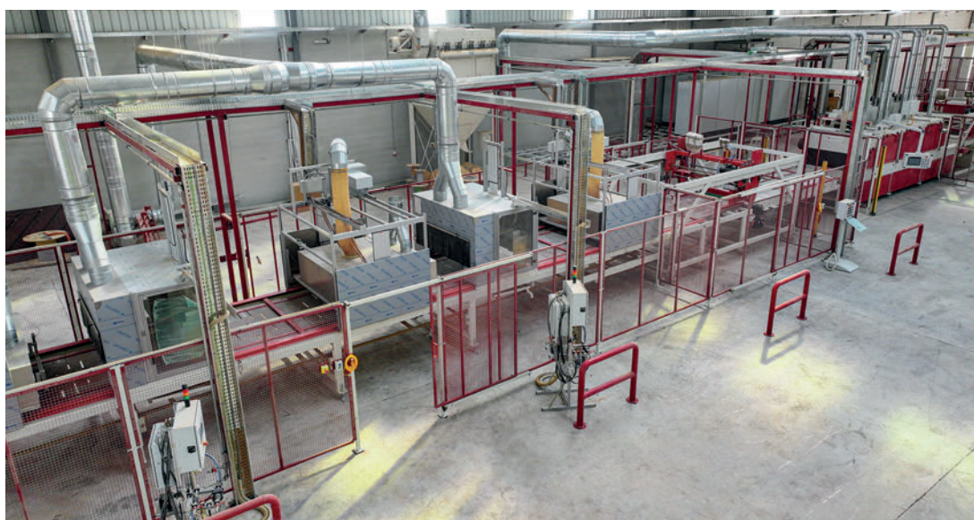
Impianto di rivestimento (durante la messa in funzione)
