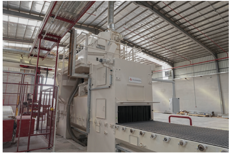
Machine de grenailage (en cours de mise en service)
