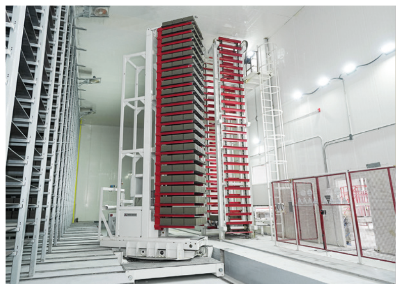
Chariot transbordeur et racks de cure du béton
