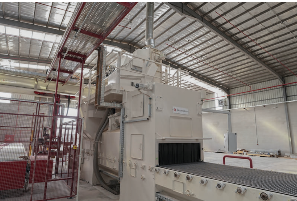
Sandstrahlanlage (bei Inbetriebnahme)
