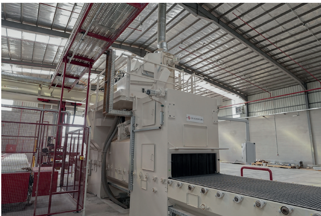
喷砂设备（调试中）
