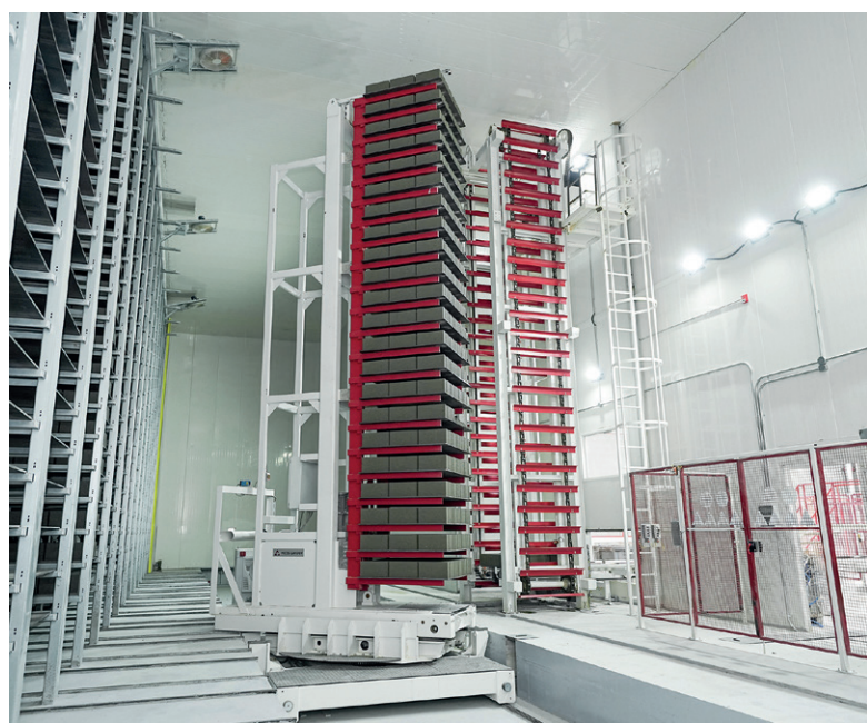
子母车系统和养护室
