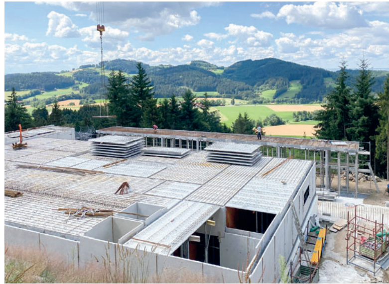
Горная гостиница в парке развлечений и отдыха Edelwies в Баварском лесу строится из сборных ж/б элементов, изготовленных на новом заводе
