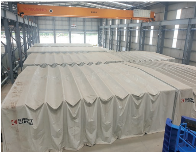
Rozsuwane namioty wewnątrz drugiego obszaru dojrzewania. W każdym namiocie mieszczą się po dwa elementy betonowe.
