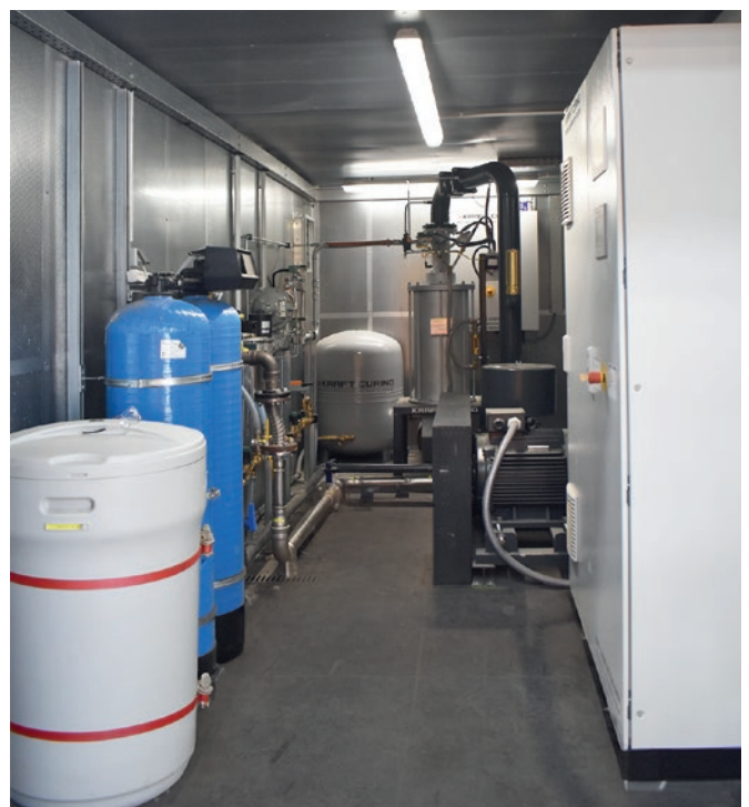
Generator pary w wersji kontenerowej, z systemem uzdatniania wody.
