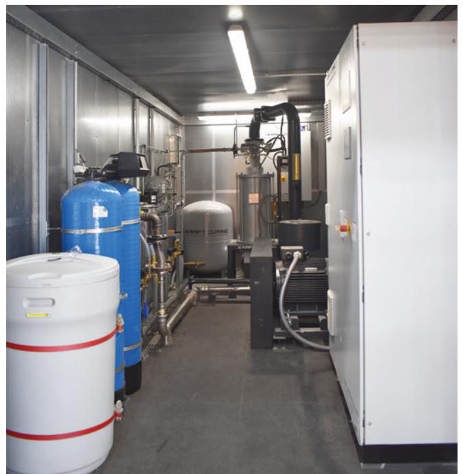
La unidad de curado con vapor en contenedor con el sistema de reciclaje de agua.
