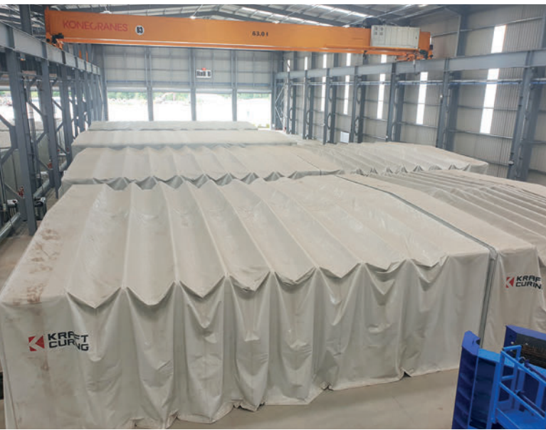
Einige der vielen einziehbaren Gehäuse im Sekundär-aushärtebereich. Jedes Gehäuse kann zwei Betonelemente aufnehmen.
