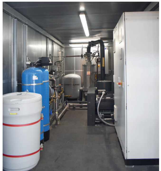
Die containerisierte Dampfaushärteeinheit mit Wasseraufbereitungssystem
