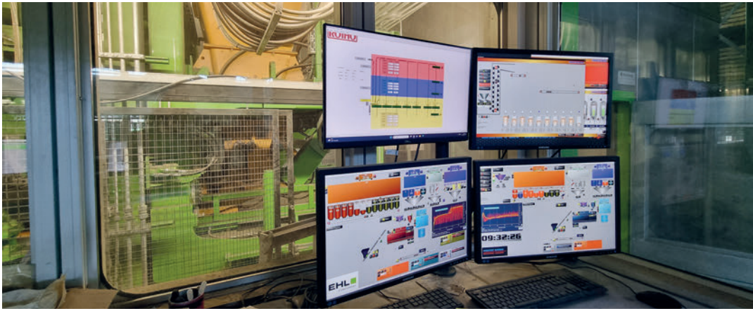
Zentrale Steuerung der Dosier- und Mischanlage über das Prozessleitsystem Sauter s-mix
