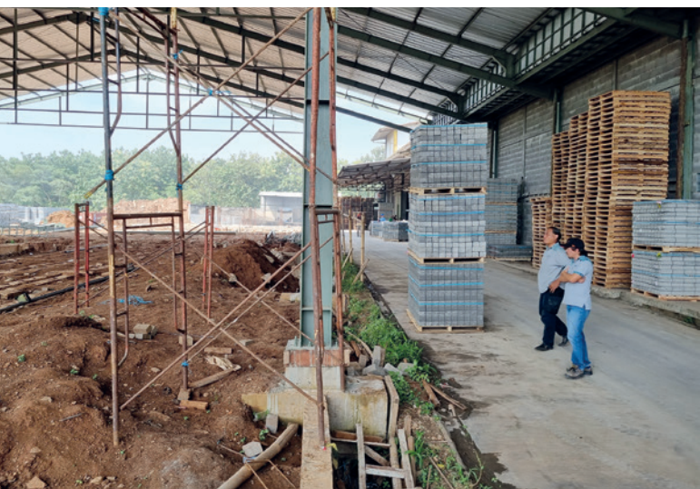
新的混凝土砌块和铺路石生产线的基础工作。右侧为 2010 年购置的海斯 RH 1500-3 混凝土砌块和铺路石机厂房
