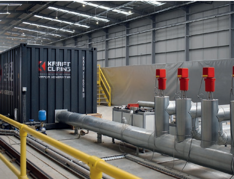
Kontenerowy generator pary wraz z 4 automatycznymi zaworami sterującymi.
