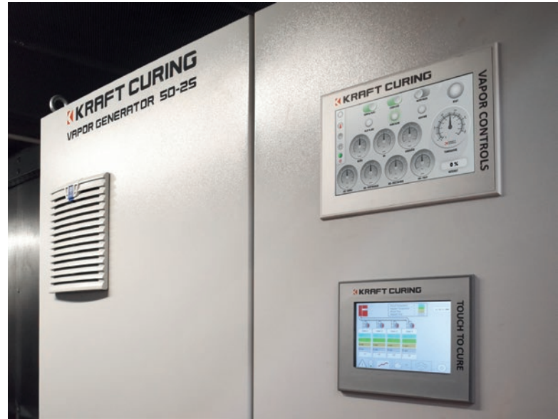
Panel dotykowy Vapor Controls (na górze z prawej) wraz z panelem dotykowym AutoCure (na dole z prawej) na szafie sterowniczej w kontenerze.
