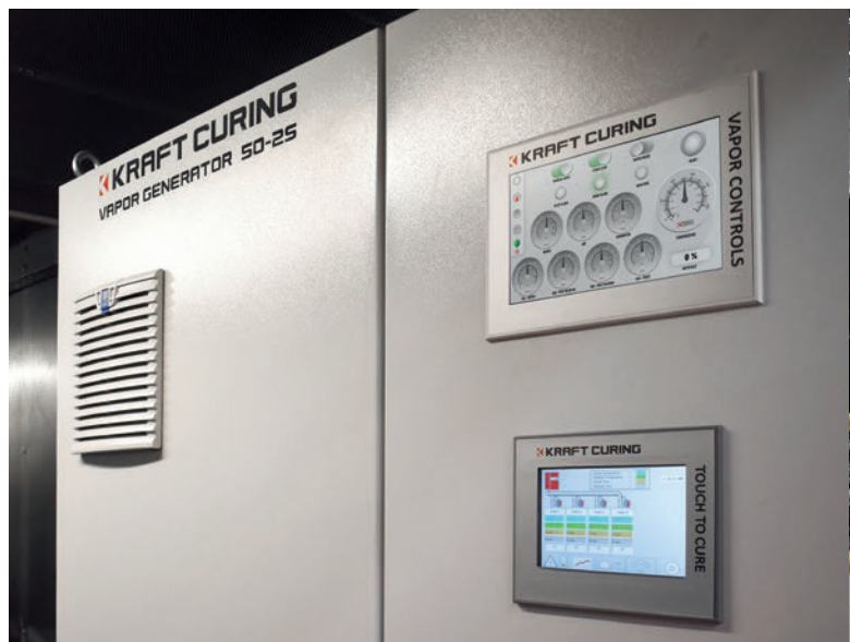
Il pannello a sfioramento dei Vapor Controls (in alto a destra) e il pannello a sfioramento AutoCure (in basso a destra) sull'armadio di controllo dell'unità containerizzata
