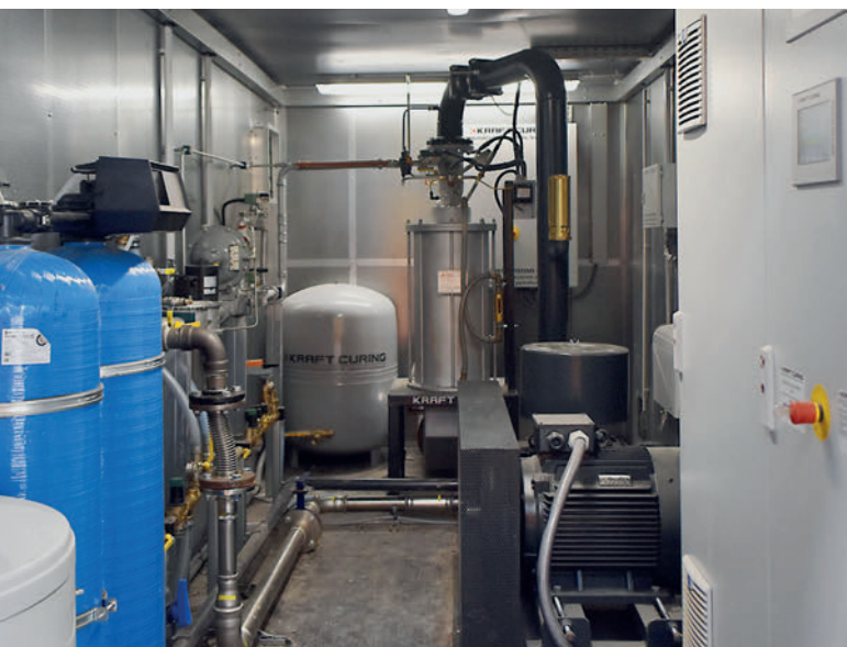
L'unità generatrice di vapore containerizzata completamente attrezzata
