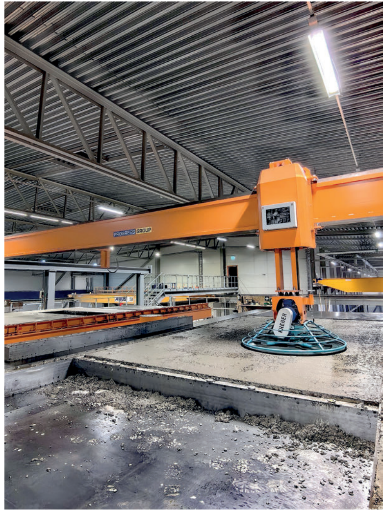
Per ottenere una superficie del calcestruzzo liscia, il calcestruzzo appena gettato e compattato va raschiato con una lisciatrice.
