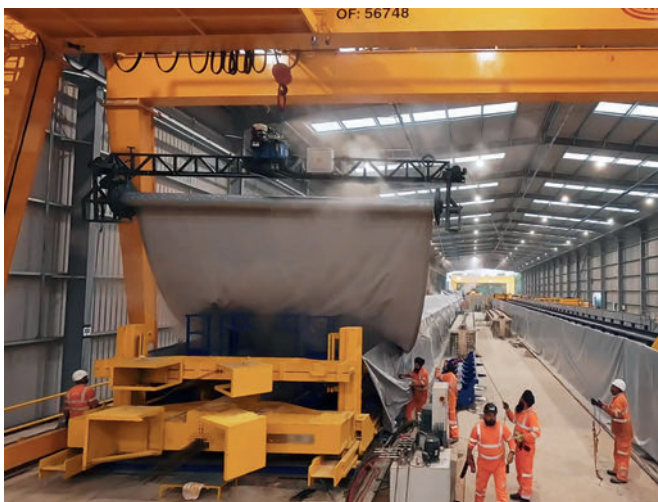
Fixé à un pont roulant, le dérouleur de bâche motorisé se déplace le long du moule afin de recouvrir uniformément les produits en béton pour le durcissement.
