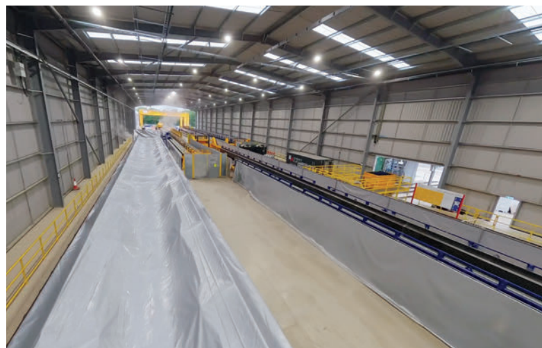
Moule de coulée recouvert d'une bâche pour un durcissement optimal du béton
