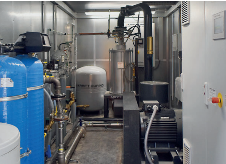
L'unité de génération de vapeur conteneurisée entièrement équipée
