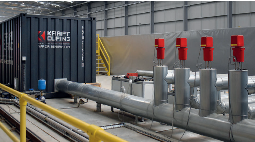
L'unité de cure conteneurisée avec ses 4 vannes de régulation automatique de la vapeur
