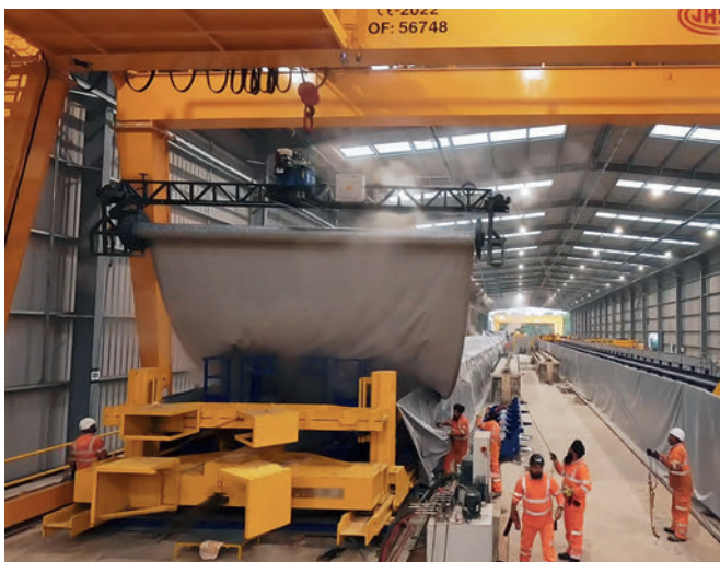
Das motorisierte Abrollsystem fährt an einem Laufkran über der Schalung entlang und rollt die Abdeckplane gleichmäßig ab.
