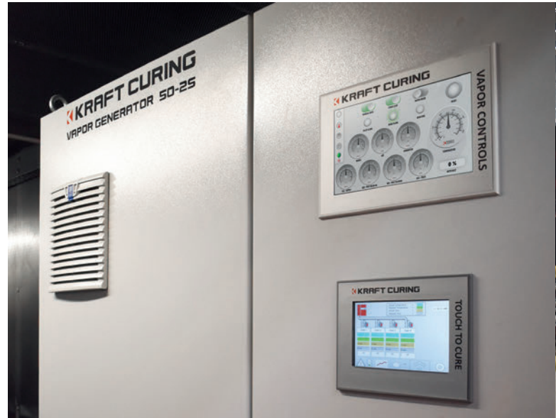
Das Touchpanel der Vapor Controls (oben rechts) und das AutoCure-Touchpanel (unten rechts) am Steuerschrank in der Containereinheit
