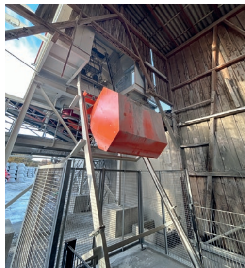
Kosz zasypowy z zabezpieczeniem przed spadnięciem.
