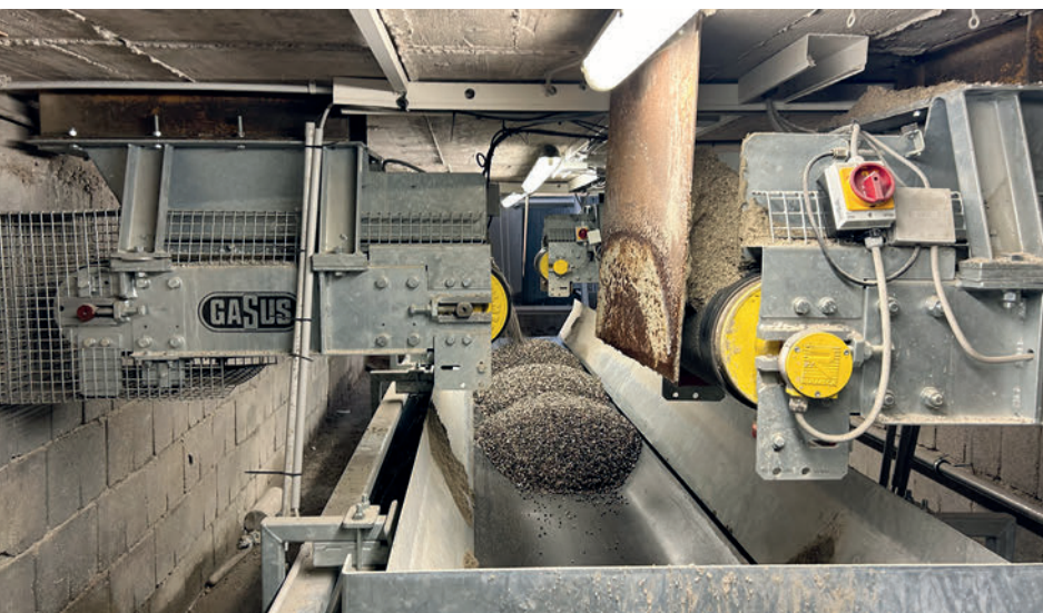
I nastri di dosaggio esistenti sotto i singoli sili per aggregati dosano sul nuovo nastro di pesatura.
