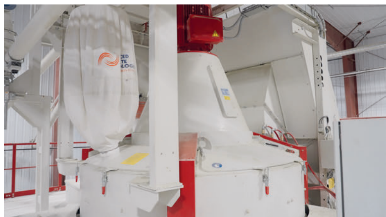
Le malaxeur HPGM-3750 assure un approvisionnement continu de la presse à blocs.
