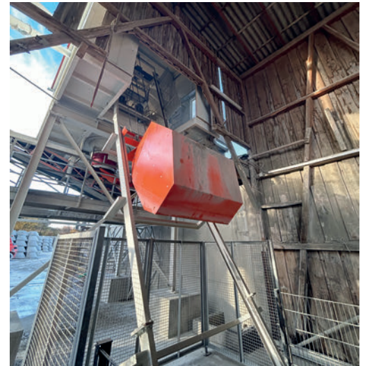
Elevador alimentador con protección anticaída
