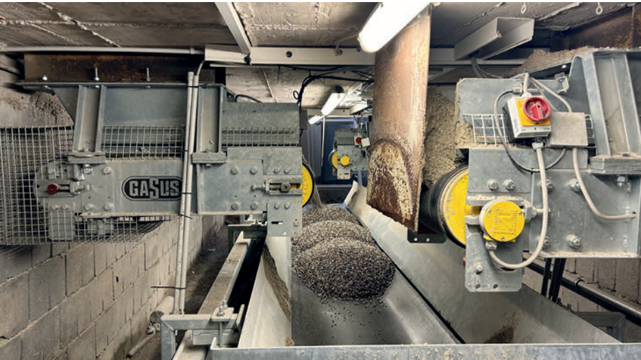
Las cintas dosificadoras situadas bajo los silos individuales de áridos existentes dosifican sobre la nueva cinta de pesaje.
