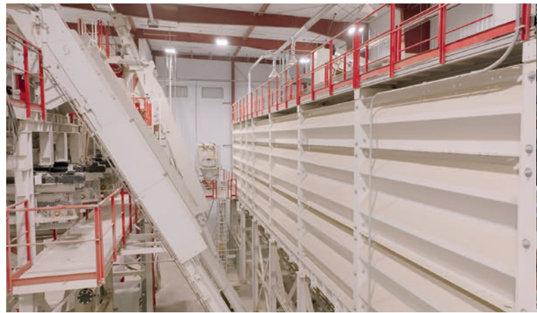
Das Innenlager mit einem Fassungsvermögen von 660 t sorgt für eine gleichbleibende Feuchte der Mischungsbestandteile.
