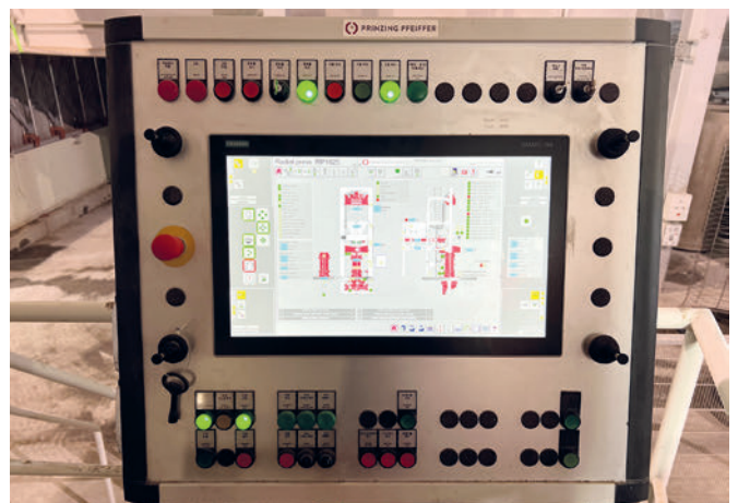
sistema di rilevamento dati e visualizzazione Karajan basato sul web, innovativo, con panoramica nonché dati macchina e produzione in tempo reale
